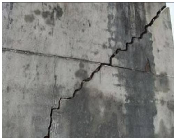
图 9.1.2-1 地基不均匀沉降裂缝
