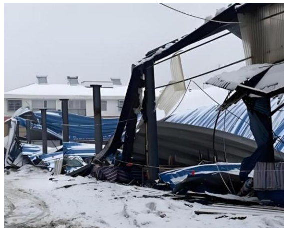
图 5.2.10-2 屋面积雪致仓库垮塌
