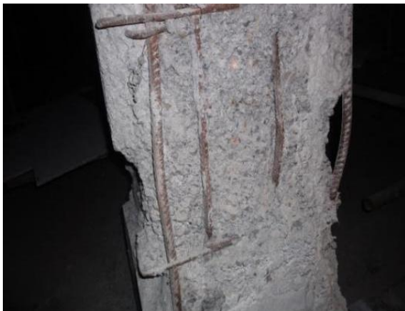
图 9.1.2-5 柱轴心受压损伤
