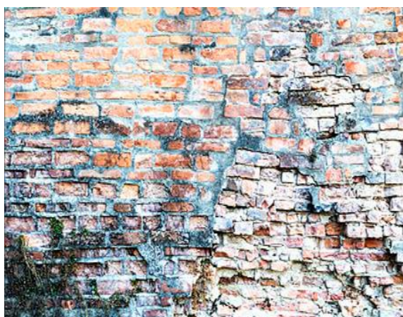
图 9.1.2-3 砌体风化剥落
