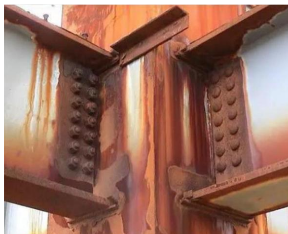
图 5.1.22-2 钢结构节点锈蚀
