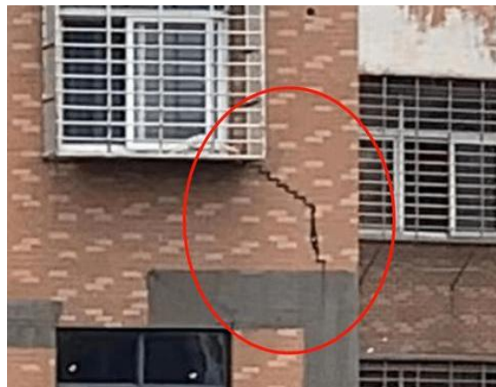
图 9.1.2-2 地基不均匀沉降裂缝
